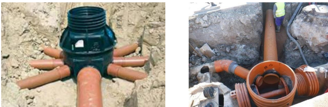
Figura 8. A la izquierda, pozo de PE con múltiples conexiones. A la derecha, pozo de PVC de reparaciones
