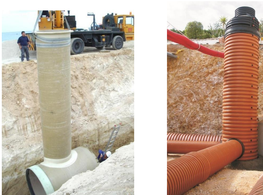
Figura 3. Pozos de sección circular, siendo el de la izquierda de poliéster reforzado con fibra de vidrio (PRFV) y el de la derecha de PVC.
