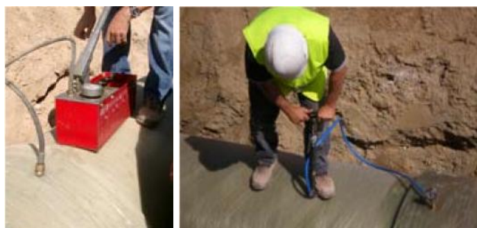
Manómetros de agua o de aire necesario para la prueba de estanqueidad
