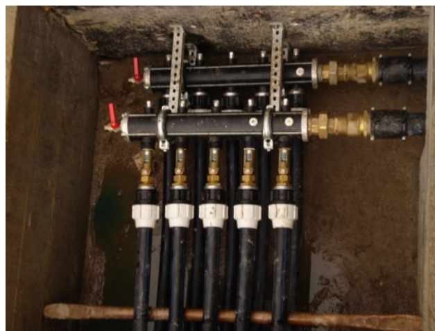
Figura 6. Colectores de ida y retorno del intercambiador geotérmico
