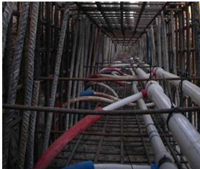
Fig. 3: Tuberías de PEXa intercambiadores de calor
